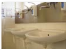
vodovodní baterie a odpady
